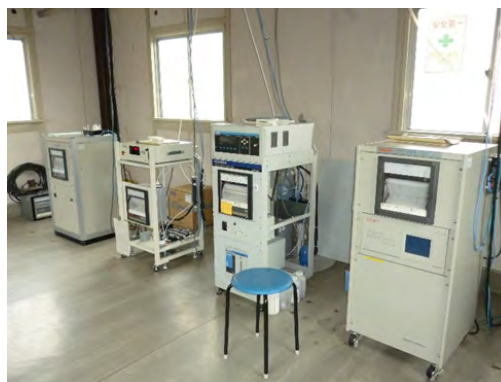
大気汚染測定局の内部
