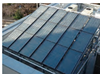
太陽熱利用 (愛知県環境調査センター)
