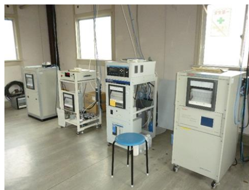
大気汚染常時監視測定局の内部
