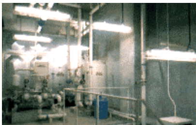
▲ 愛知県図書館の雨水利用施設(ポンプ室・受水槽)
