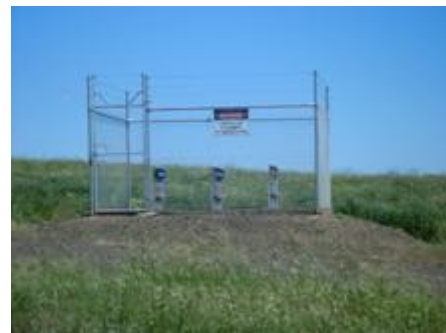
処分場内に設置されたガス回収装置
