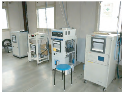
大気汚染常時監視測定局の内部
