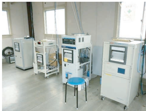
大気汚染常時監視測定局の内部
