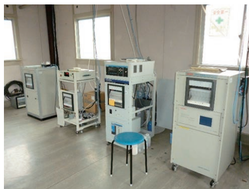
大気汚染常時監視測定局の内部
