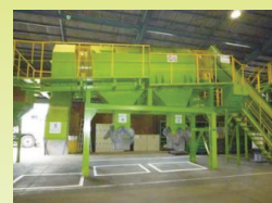
循環型社会形成推進 事業費補助金対象設備
